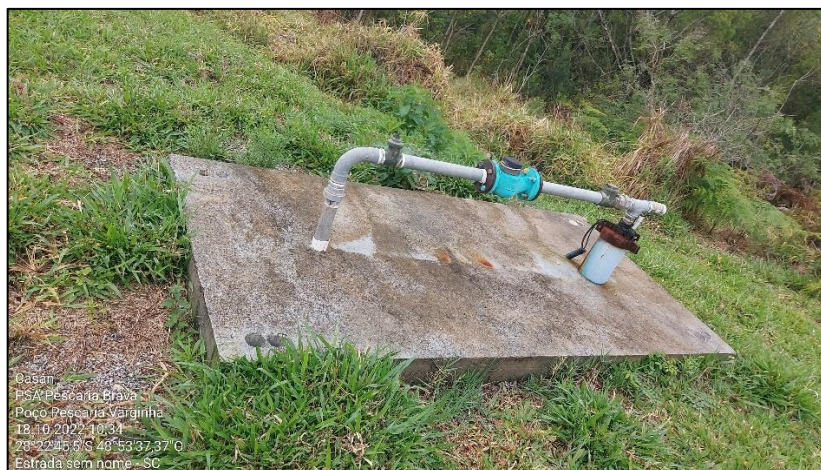
Figura 2 – Captação subterrânea poço P1 – ou Poço da varginha.
