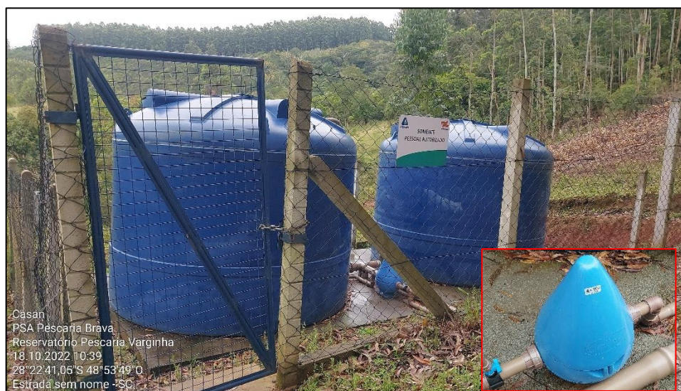
Figura 3 – Dosador e reservatórios Varginha
